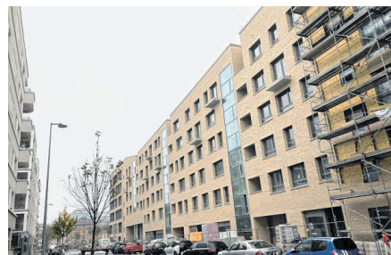
Auf der Baustelle des Postquadrats in der Schwetzingenstadt ruhen die meisten Arbeiten. Nur an den Außenanlagen werden sie fortgesetzt.
