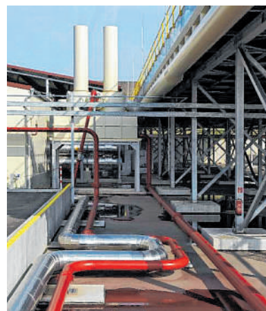
Die Geothermie-Anlage in Inenheim: Vorbild für Mannheim? BILD: KLAUS VENUS
