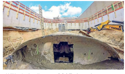
„Wilhelmine“ war 2017 im eingestürzten Tunnel einbetoniert worden. Foto: dpa
